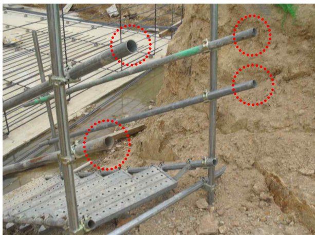
조치전) 가설계단 수평재 단부 보호캡 미설치
