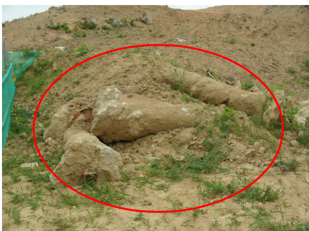
조치전) P1 주변 폐콘크리트 적치
